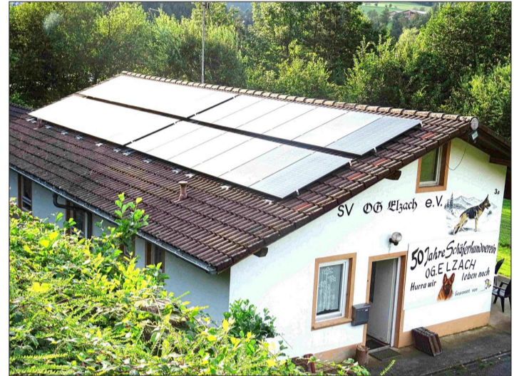
Beim Schäferhundeverein Elzach wurde eine Photovoltaikanlage auf dem Dach des Vereinsheims installiert. Fotos: BEG
